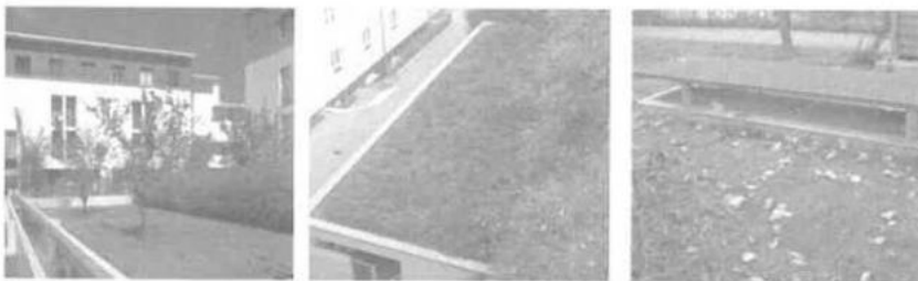
Exemples illustratifs : toiture terrasse végétalisée, dalle de parking, dispositif de végétalisation hors sol,
